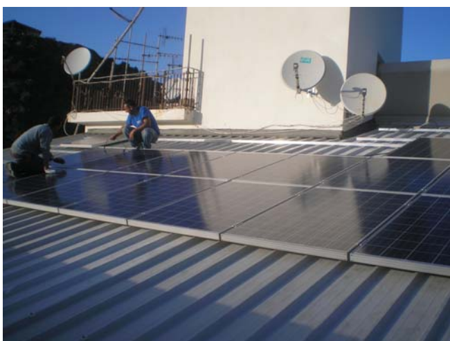
2 Impianti da 3KWp S. Margherita Messina
