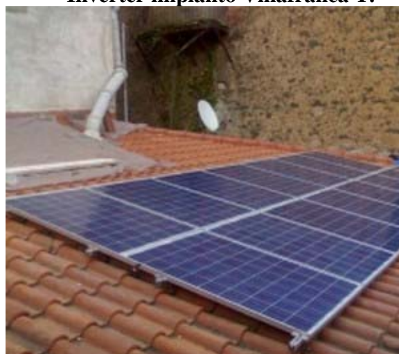
3 KWp prov. Di Catania
