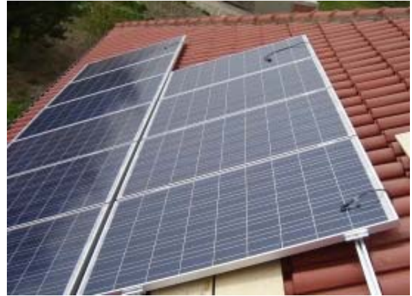
3 KWp S. Cataldo
